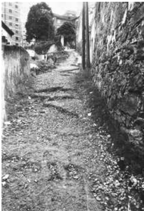
Imagen 4: Lastimoso estado de uno de los caminos que comunicaban los barrios de Zurbaran y Zurbaranbarri.
